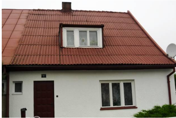
Rys. 6. Pokrycie dachowe ocenione w III stopniu pilności.
