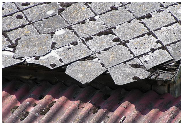
Rys. 8. Pokrycie dachowe ocenione w I stopniu pilności.
