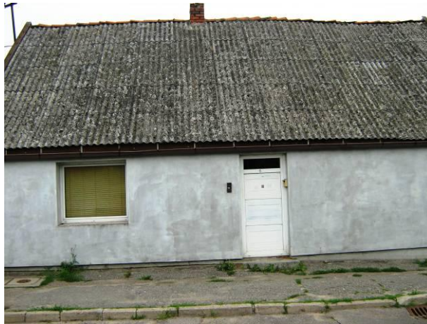
Rys. 7. Pokrycie dachowe ocenione w II stopniu pilności.
